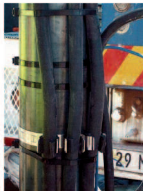
Ceinture inox avec clips de maintien des câbles d'alimentation de la pompe
