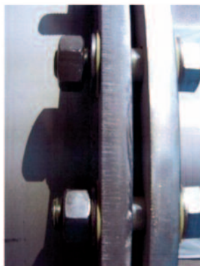
Protection cathodique : joints diélectriques pour raccordement au réseau
